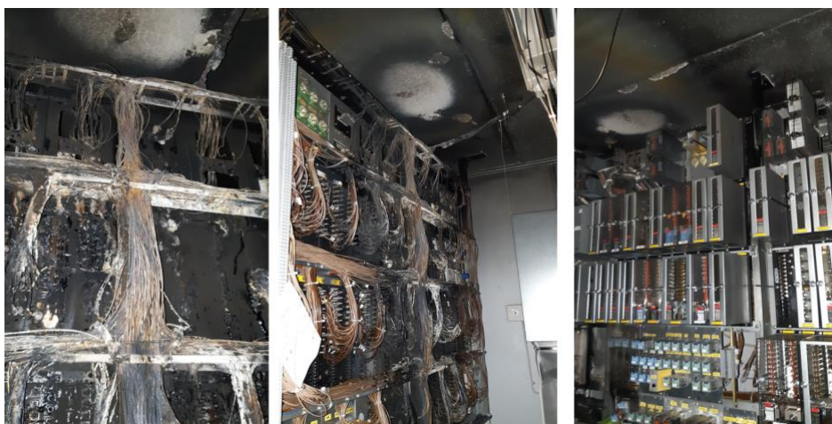
Skador i ett teknikskåp efter ett åsknedslag.
